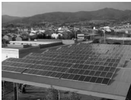
Figura 4.14. Esquerra: captadors de tub de buit. Dreta: instal·lació d'energia solar tèrmica amb captadors de tub de buit de la coberta de la pista poliesportiva del Club Natació Terrassa.
