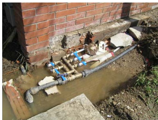
Nova bateria de vàlvules i canonades
