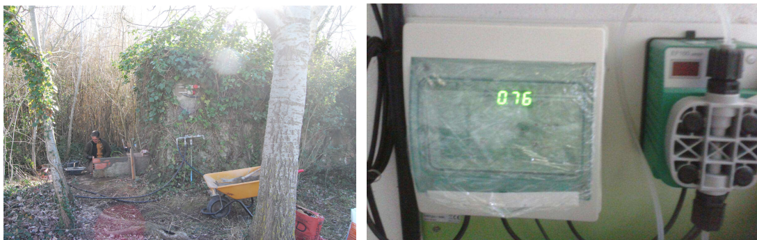
Fot. M1 i M2 – Arribada d'aigua al dipòsit i equip de control de cloració.
