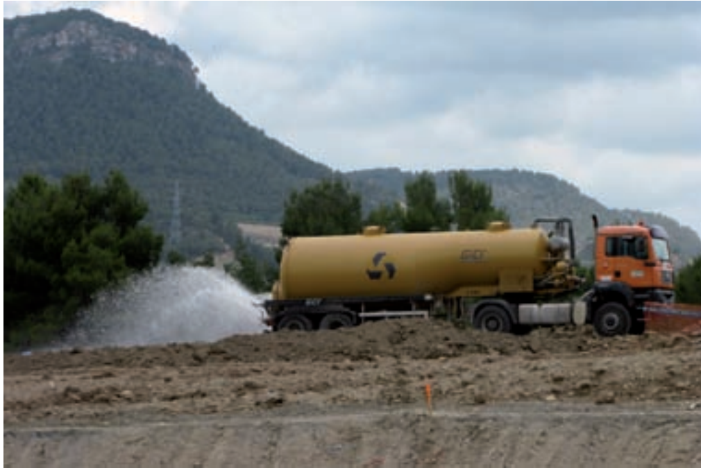
Cisterna regant per reduir la pols generada pel moviment de maquinària de les obres
