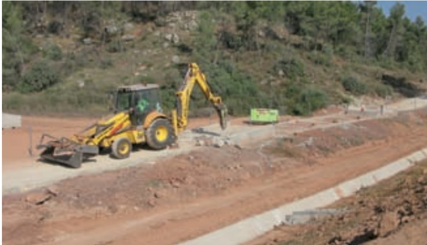
Desmantellament de les instal·lacions de l'obra: piconatge de la zona de la bàscula per procedir a la seva restauració
