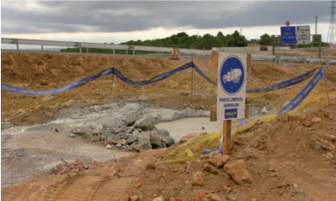
Punt impermeabilitzat per al rentat del formigó
