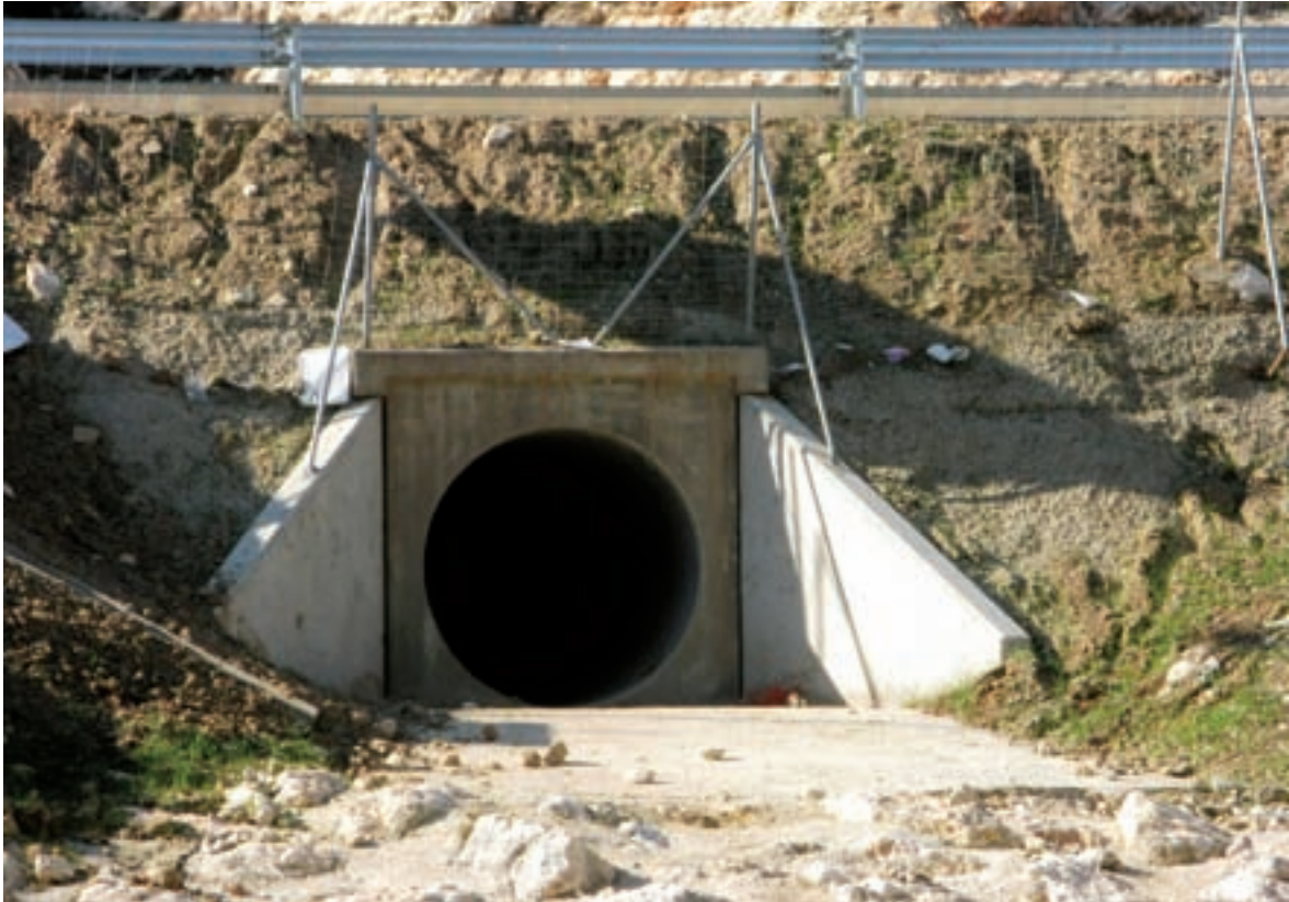
Drenatge adaptat com a pas de fauna amb emmacat de pedra d'accés
