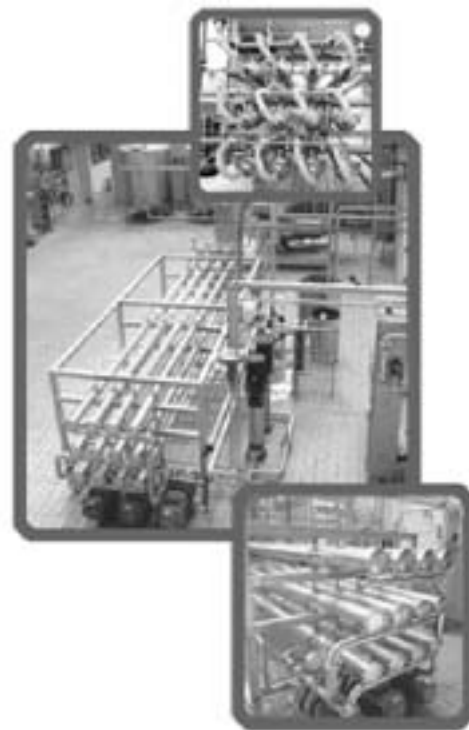
Figura 59: Equipament d'osmosi inversa (cortesia de Perinox, S.A (95))
