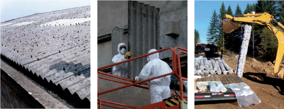
Procés de desamiantització d'un edifici. En aquest cas, plaques i tubs de fibrociment.
