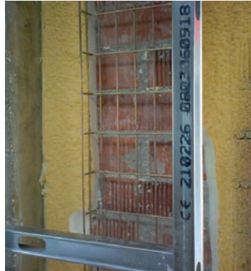
Pont tèrmic per problemes d'execució
