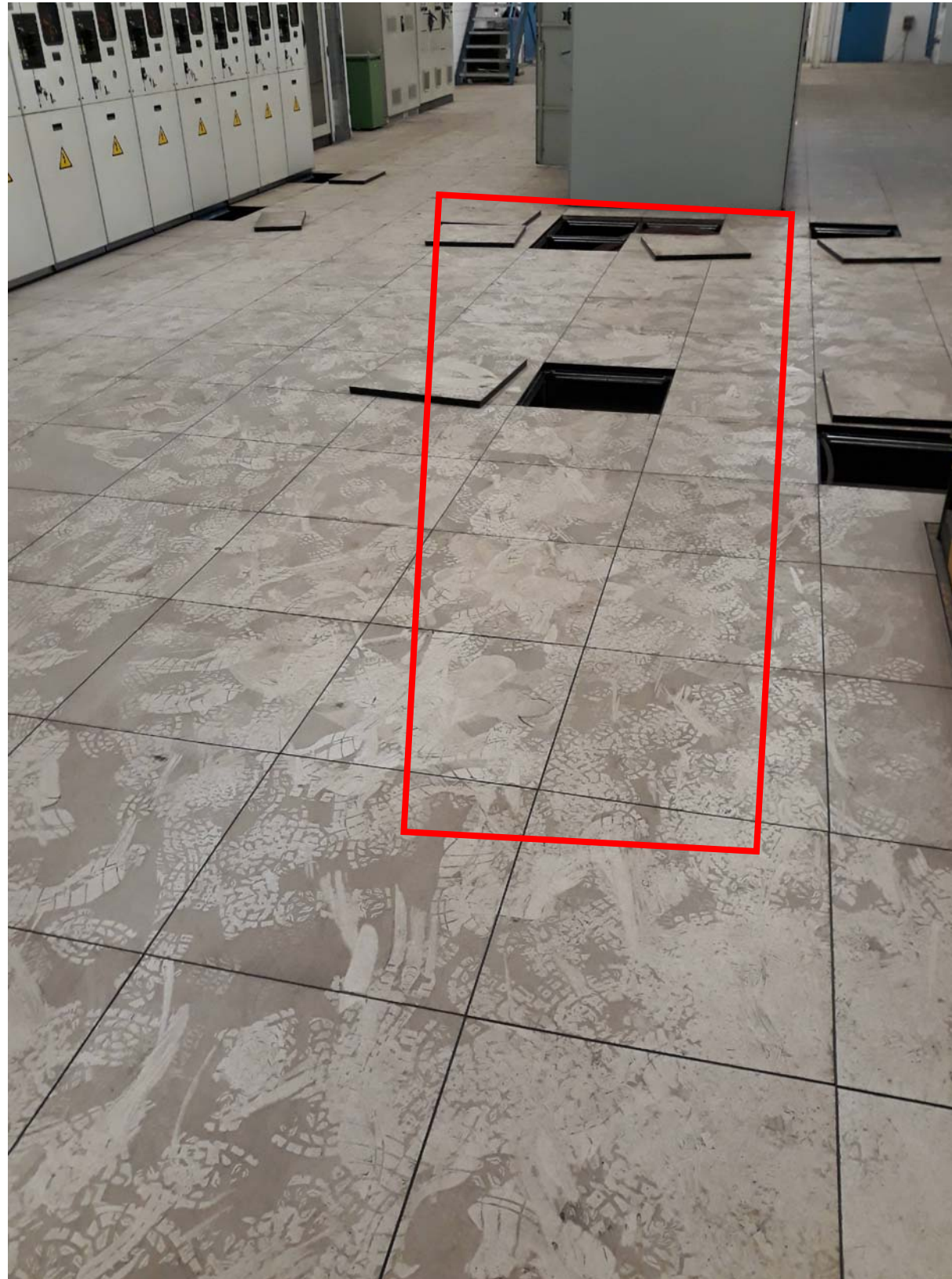
Zona instal·lació cabines MT a l'interior SC E. Lluch L5 (cabines escomesa secundari auto transformador)
