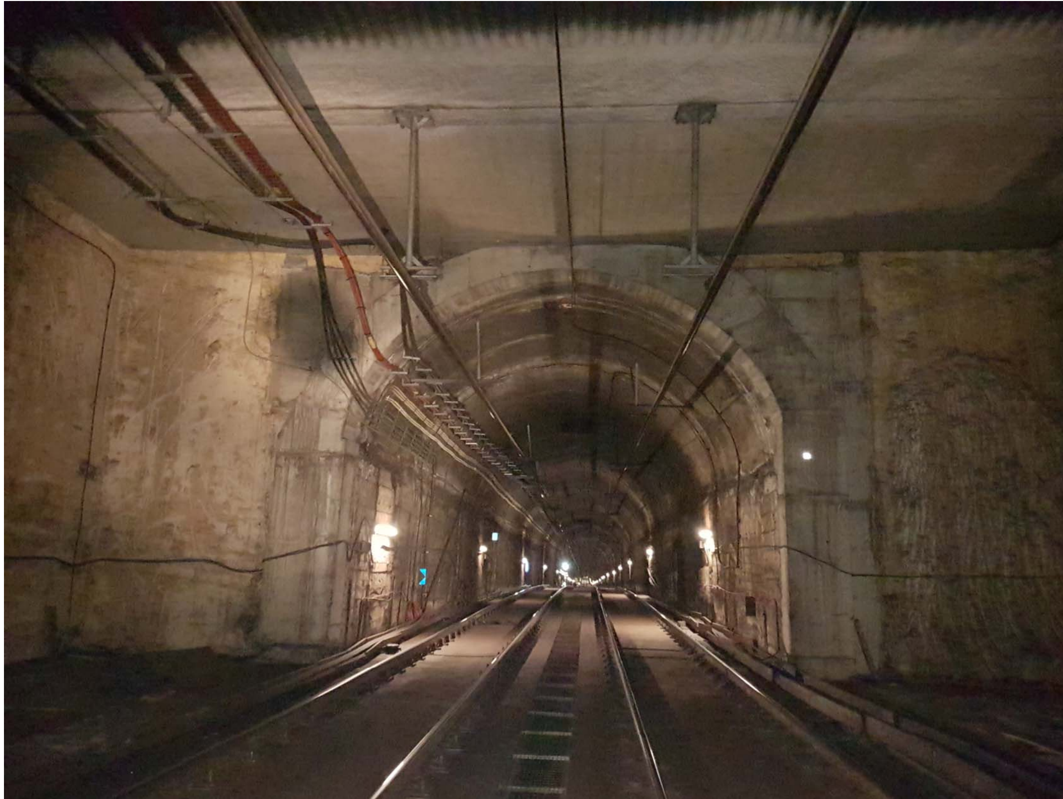
Entrada de materials a sotscentral. Nivell andana, mirant cap a Pubilla Cases
