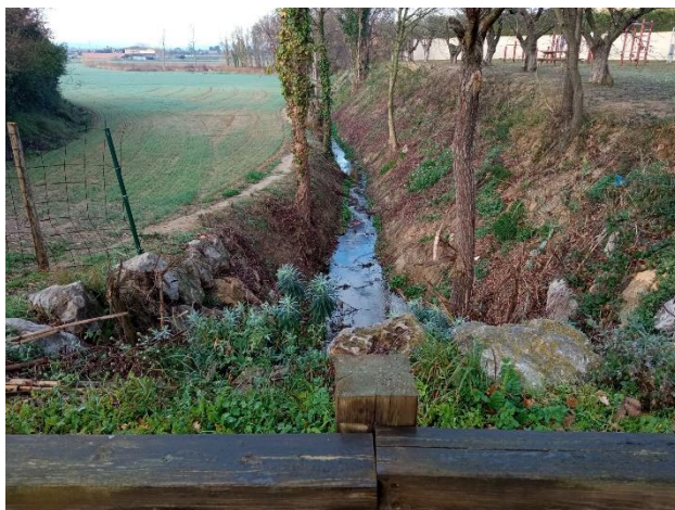
Fotografia 1. Talús de marge de rec fluvial amb petits esclavissaments de magnitud baixa. Àrea A1 Perillositat baixa
