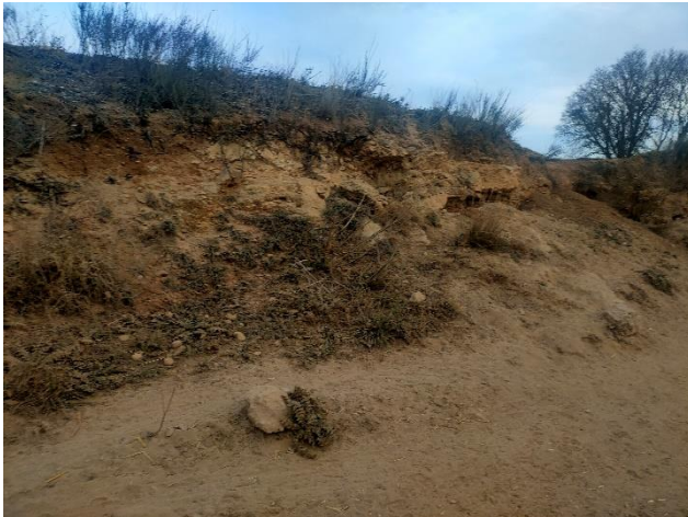
Fotografia 10. Zona amb talussos de desmunt en capes de gresos i argiles amb processos de lliscaments i erosió i blocs caiguts. Camí de Siurana. Àrea C4 Perillositat baixa
