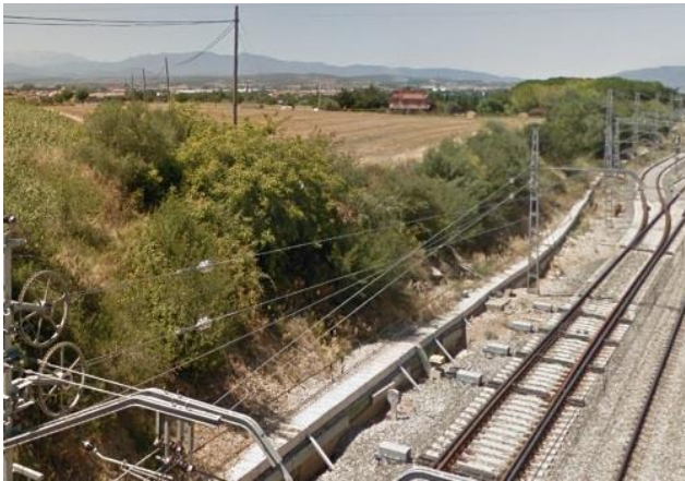
Fotografia 13. Talussos de desmunt del marge de la via del tren, en gresos i argiles, amb processos de lliscament de magnitud baixa i formació de xaragalls per escorrentia. Via fèrria al nord de Tonya. Àrea C6 Perillositat baixa
